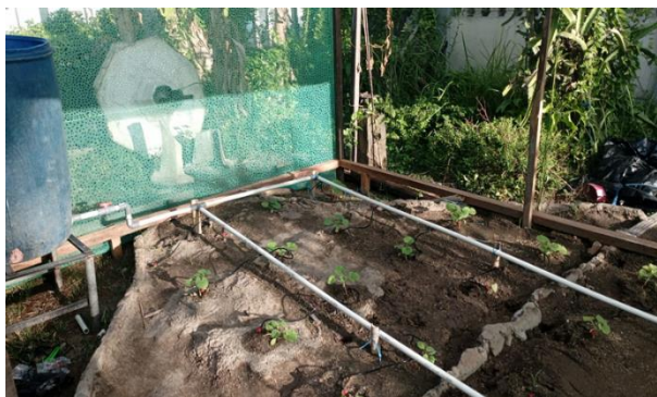
Gambar 3. Instalasi Irigasi Tetes
